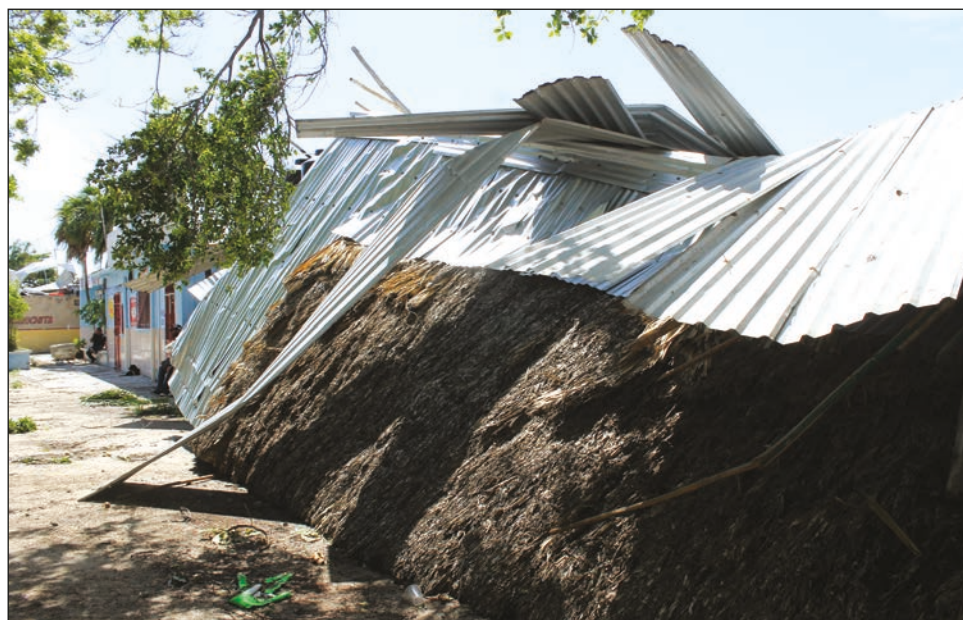
▲ El pasado miércoles, vientos de hasta 50 kilómetros por hora derribaron los techos de al menos ocho viviendas. Foto Gabriel Graniel
