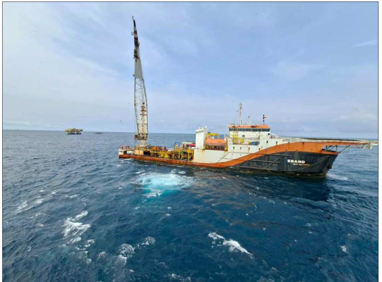
▲ “Inmediatamente se activó el protocolo de inspección submarina en el área, detectando poro en un ducto de la plataforma Chuc-1, procediéndose a las acciones de reparación, las cuales concluyeron el 6 de octubre”, afirmó Pemex en redes sociales. Foto ASEA
