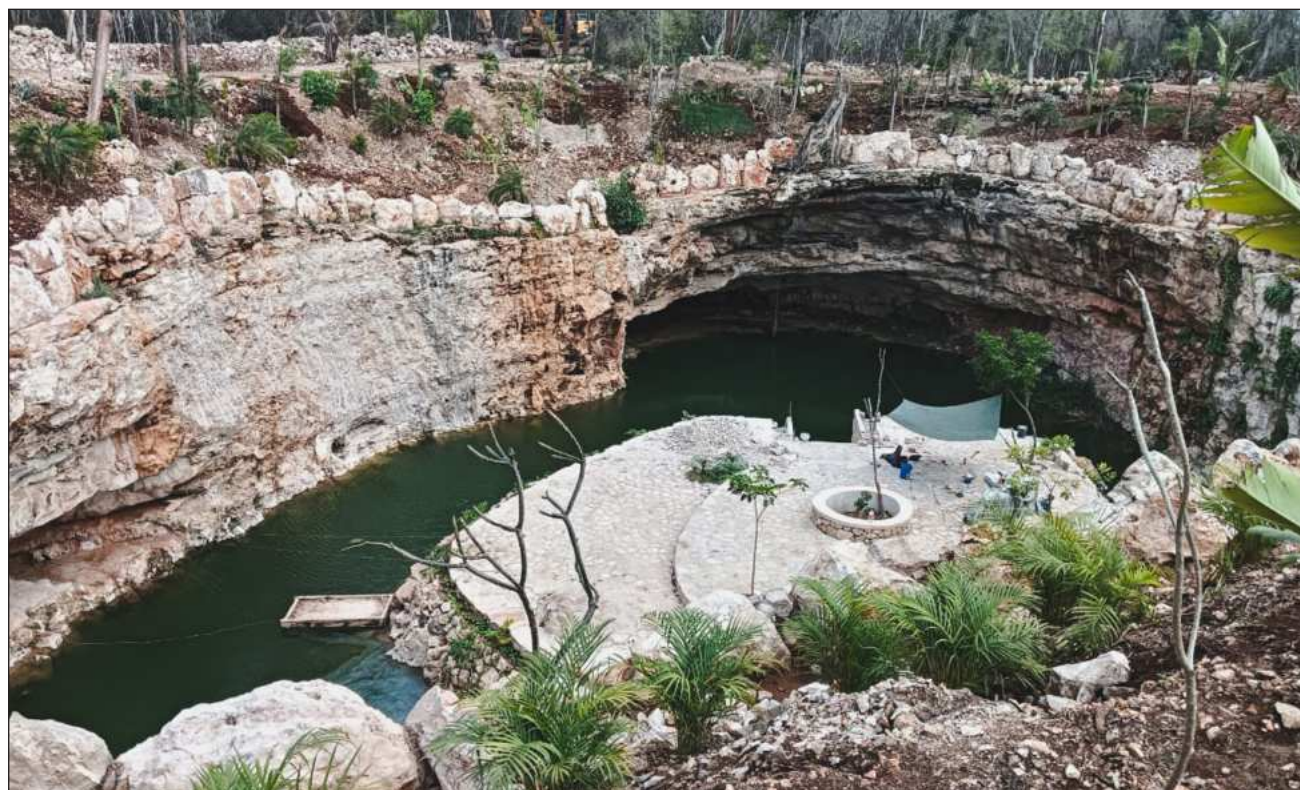
▲ La Profepa detectó diversas obras en proceso, entre ellas la apertura de un camino de acceso, la perforación de un cenote y excavaciones tipo mina entre dos puntos, presuntamente para conectarlos mediante un canal. Foto Profepa
