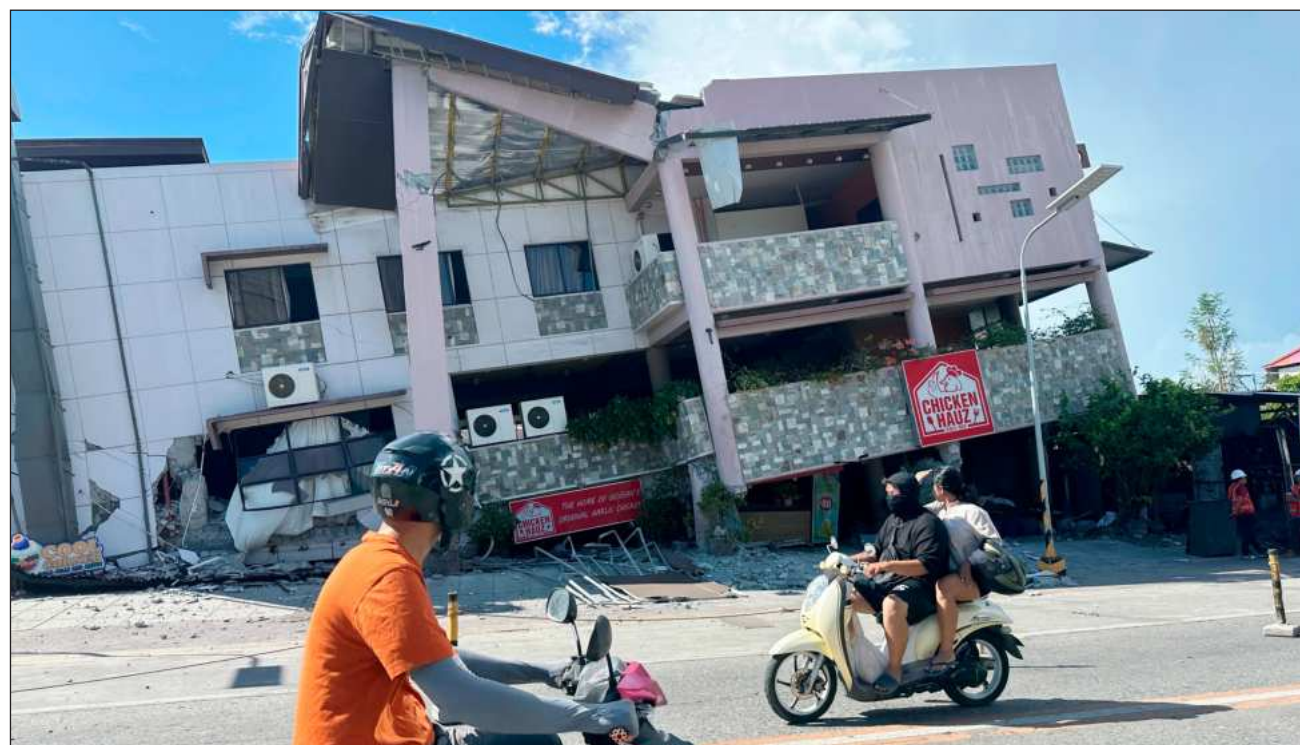
▲ Es el peor terremoto en Filipinas en lo que va de año, declaró Teresito Bacolcol, director del Instituto Filipino de Vulcanología y Sismología. Advirtió a la gente que buscara asesoramiento antes de regresar a edificios y casas dañados que podrían colapsar. Foto Reuters
