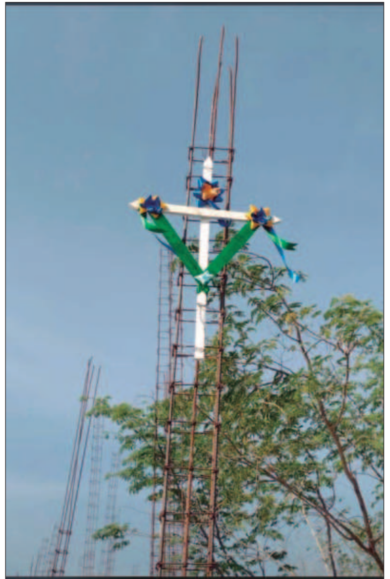
▲ “La fiesta del día del albañil inicia con la instalación de la cruz hecha con desperdicios de madera y colocada en lo alto de la obra en construcción (...) algunas veces se improvisa un altar y colocan veladoras”. Foto Lourdes Rejón Patrón
