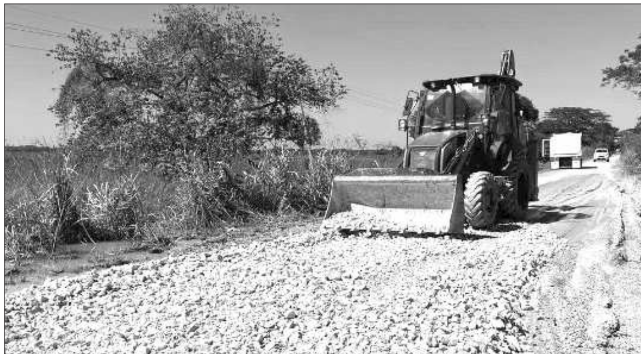
▲ El diputado Francisco Farías Bailón acusó la inacción de la SICT, así como del gobierno de Campeche, pues este desbordamiento de la laguna se debe a los trabajos del Tren Maya cercanos. Foto Facebook Francisco Farías
