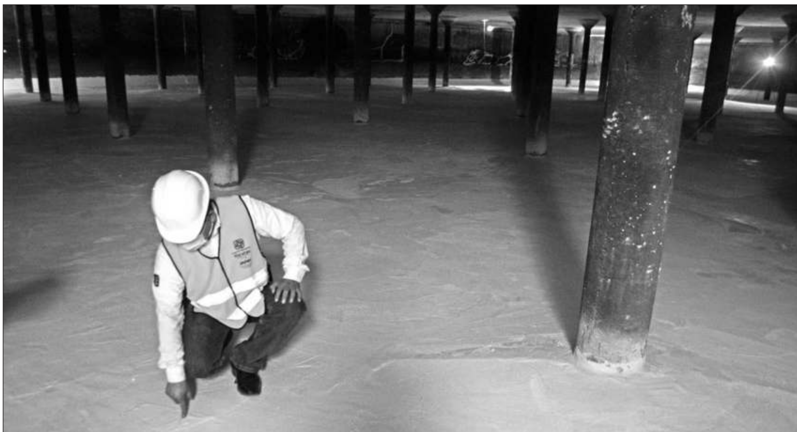
▲ El deterioro en el cárcamo de la colonia García Ginerés provocaba la pérdida de 20 centímetros cúbicos de agua cada hora, lo que equivale a 800 tinacos convencionales cada hora, o 10 millones de litros al día, indicó Sergio Chan Lugo, director de la paraestatal. Foto Rodrigo Díaz Guzmán
